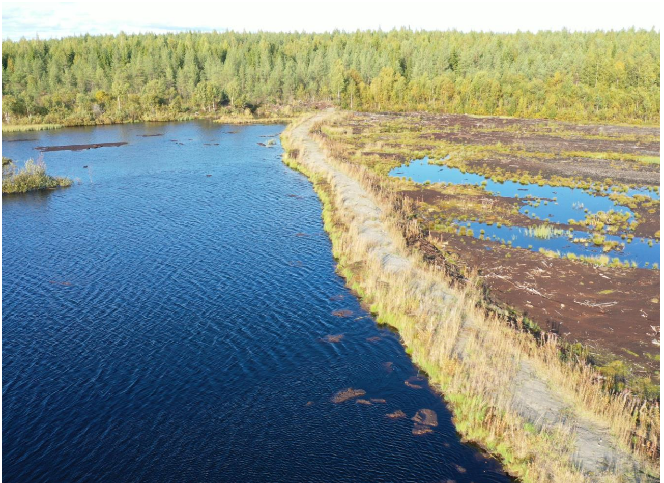
Kahden eri kosteikko-osa-alueen väliin rakennettu patopenger Sotkamon Ansosuolla. Patopenkereen korkeus on n. 2 m, harjan leveys 1,3 m ja pituus 170 m. Penkereen rakentamiseen kului 55 kaivurituntia.
